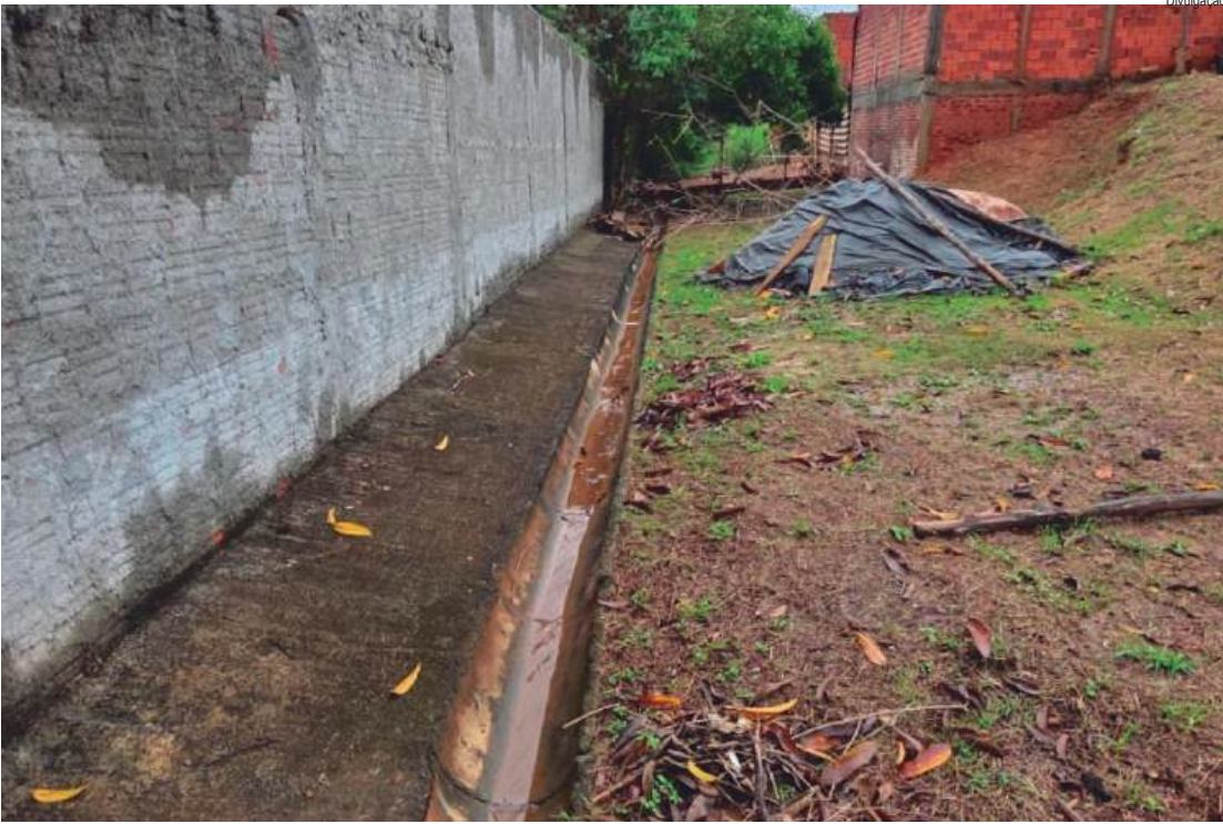
Pedro Kawai esteve no local a pedido dos moradores e protocolou indicação para avaliação e adequação do sistema de drenagem de águas pluviais existente
