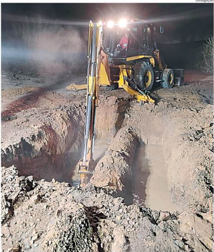
Rompimento adutora de água bruta Capim Fino aconteceu na madrugada de domingo
