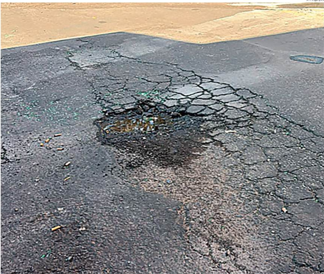
Vias apresentam buracos, trincas e pontos de deterioração do asfalto
