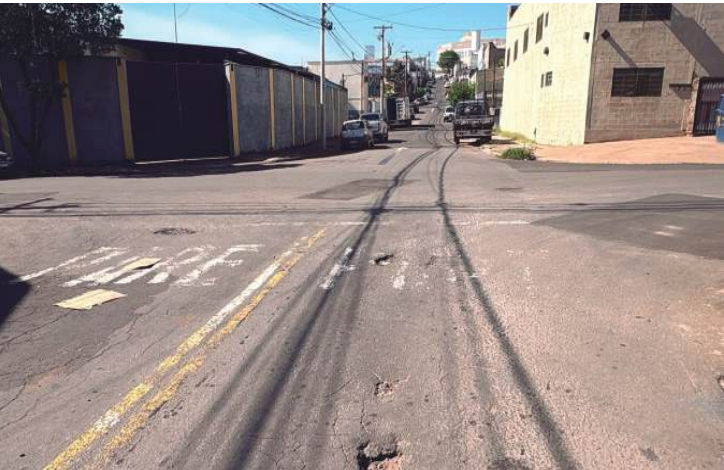
Pedro Kawai (PSDB) apontou a falta da inscrição "PARE" em diversos cruzamentos do bairro
