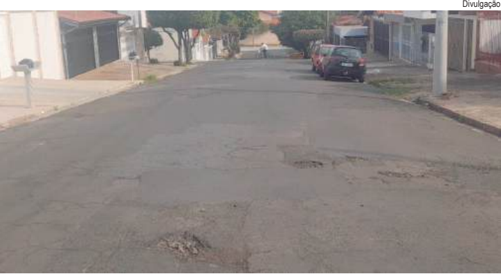
Rua Alexandre Petta apresenta desgaste acentuado que compromete o tráfego de veículos
