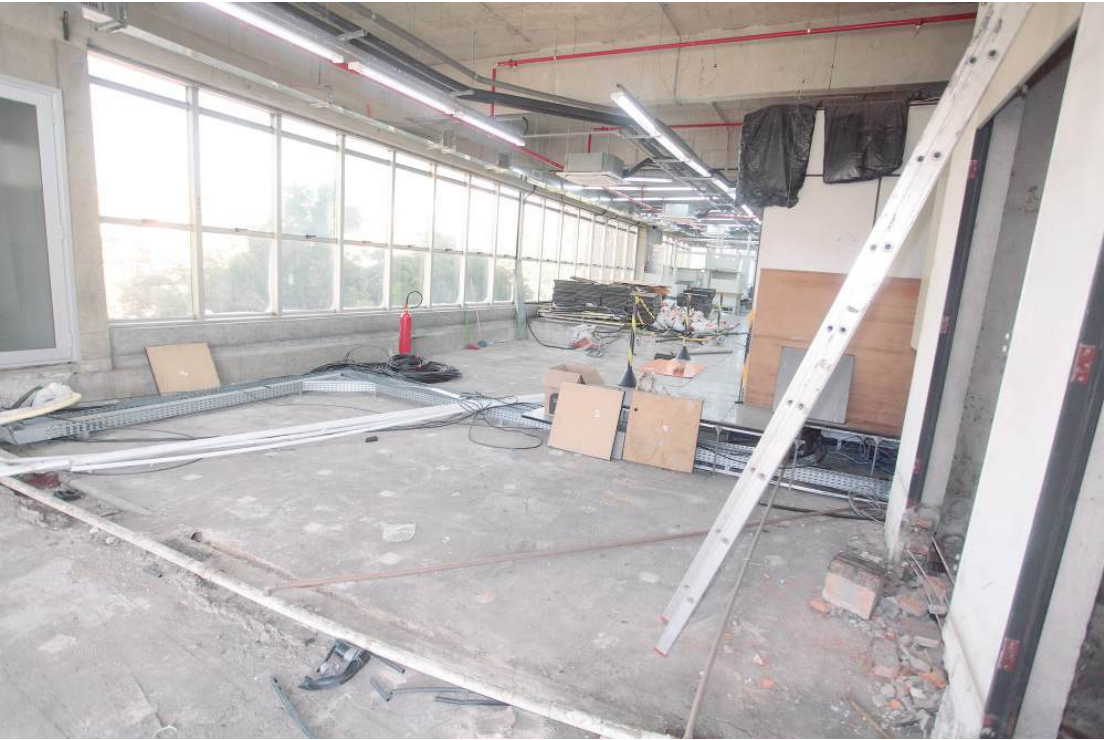
Reforma vai garantir mais segurança, estabilidade e capacidade para os serviços digitais utilizados pela administração pública
