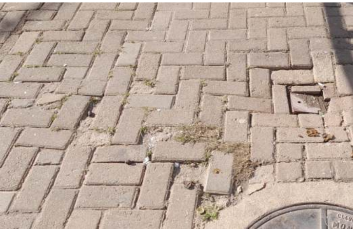
Pedro Kawai (PSDB) solicita a realização de manutenção no piso intertravado da calçada do Largo dos Pescadores
