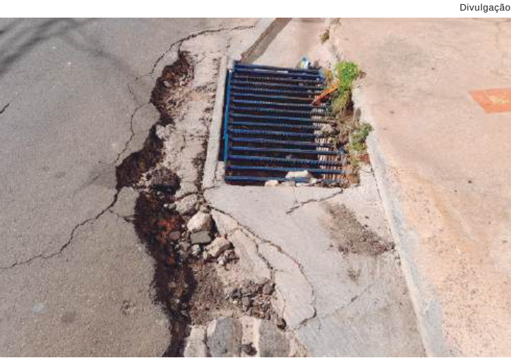
Via do bairro Paulista apresenta desgaste, erosão do pavimento, afundamentos e desagregação do concreto
