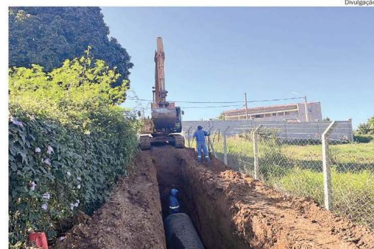
Intervenção transfere trecho da rede para fora da área da Escola Municipal Antonia Jesuína Camilo Pipa e facilita futuras manutenções
