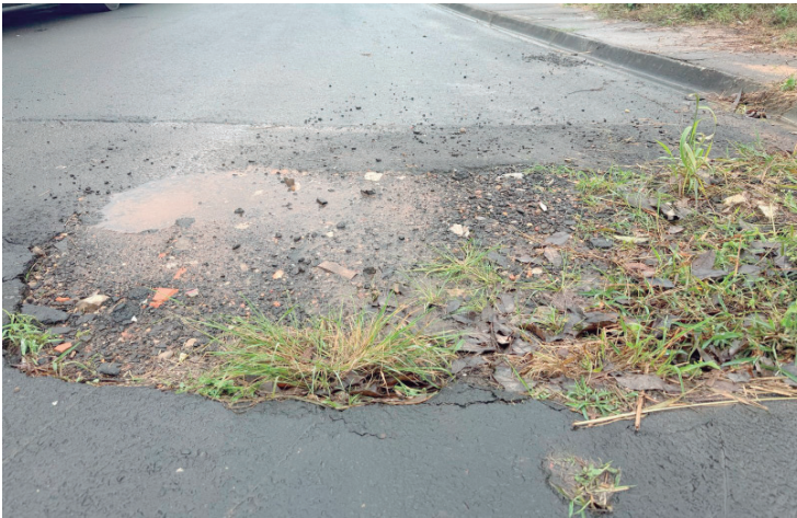
Solicitação de reparos de emergência na rua Francisco Perez Gonzales será encaminhada pelo vereador Josep Borges ao Semae após vistoria no local
