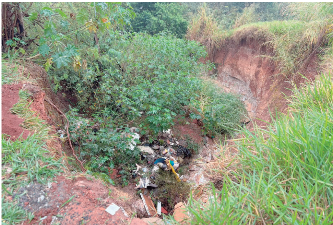
Pedro Kawai (PSDB) indica a necessidade de realização de contenção de erosão e a implantação de tubulação para águas pluviais no local
