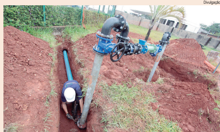
Dezoito condomínios residenciais foram beneficiados com a instalação dos equipamentos do Semaef
