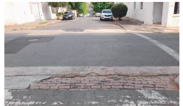
Deterioração, desníveis, afundamentos e desgaste do pavimento comprometem o escoamento adequado das águas pluviais
