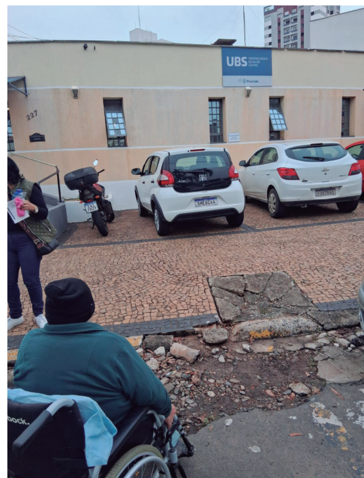
Pedro Kawai (PSDB) aponta que a situação compromete a circulação segura dos usuários e pode representar risco de quedas e acidentes
