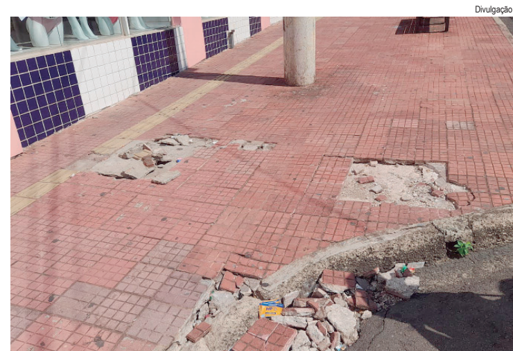
Vereador Pedro Kawai (PSDB) ressaltou, em indicação, que as chuvas comprometeram a estrutura da drenagem e o afundamento da calçada
