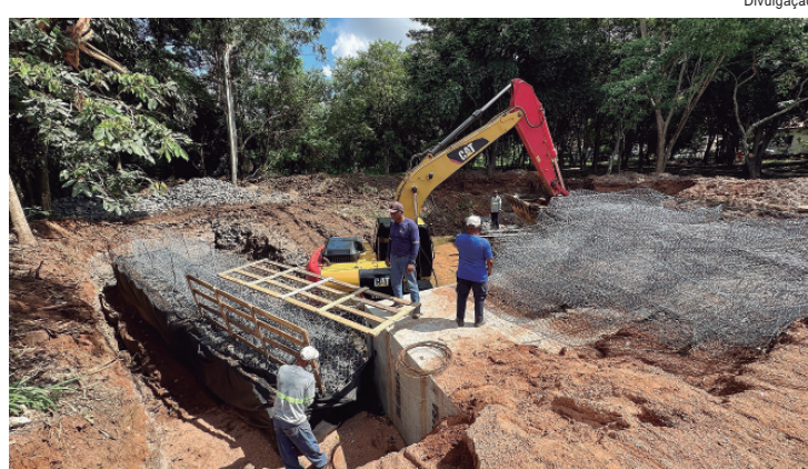
E para evitar erosões e dar sustentação ao leito do córrego, a equipe está construindo o chamado gabião
