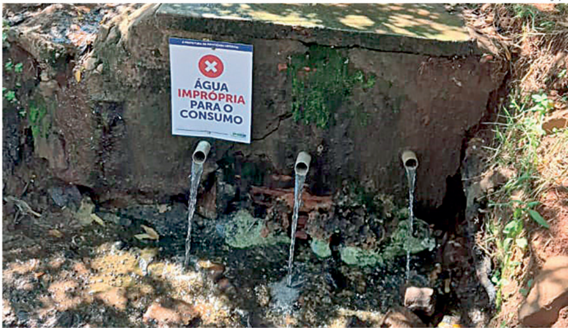
Bica no bairro Altos do São Francisco está imprópria para consumo e prefeitura instalou placa alertando a população
