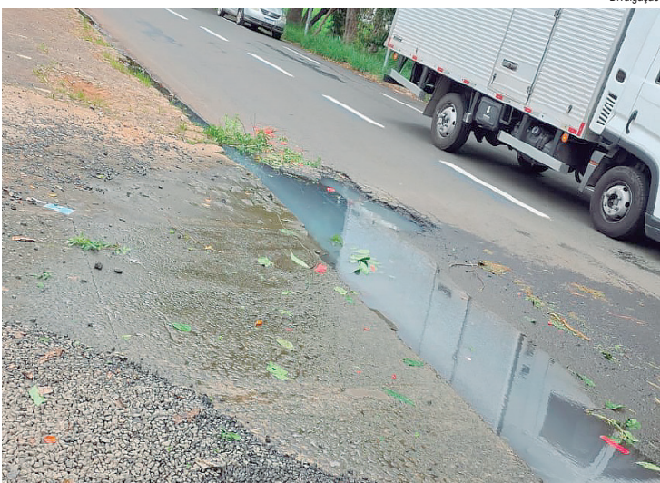
Pedro Kawai (PSDB) aponta que há um buraco junto à guia da via que já começa a avançar sobre a faixa de rolamento
