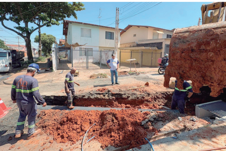
As intervenções devem contribuir para melhorar o escoamento das águas pluviais, a segurança e as condições de infraestrutura urbana
