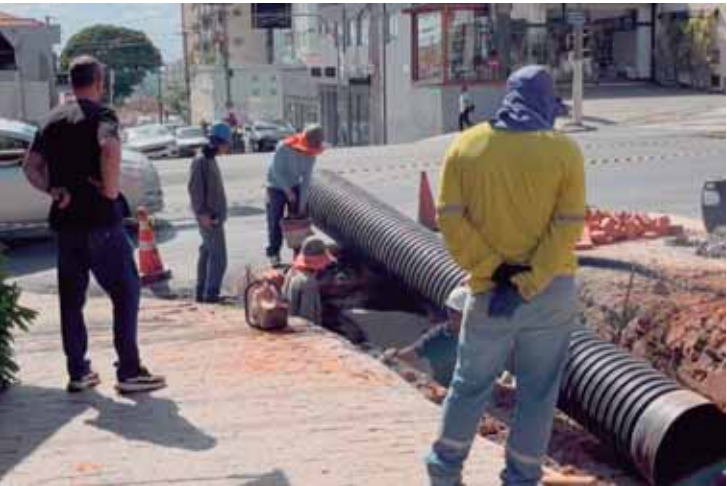
Pedido partiu do vereador Felipe Gema. Obra deve solucionar transbordamento na Rua Dom Pedro I com Avenida Independência
