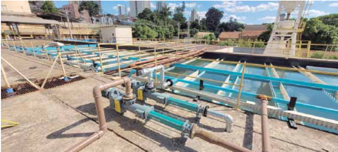
Equipamentos para remoção automática de lodo na ETA Luiz de Queiroz foi instalado em uma ação de modernização da unidade em outubro de 2025
