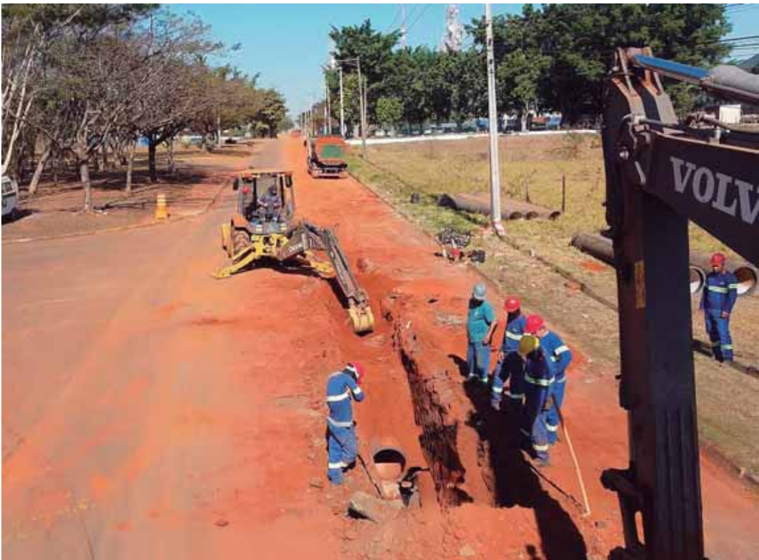
Adutora conta com tubulação em ferro fundido de 600mm
