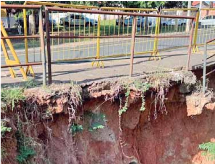
Renan Paes acompanhou nesta segunda (19) serviços de desassoreamento em córrego pelo qual passa ponte danificada
