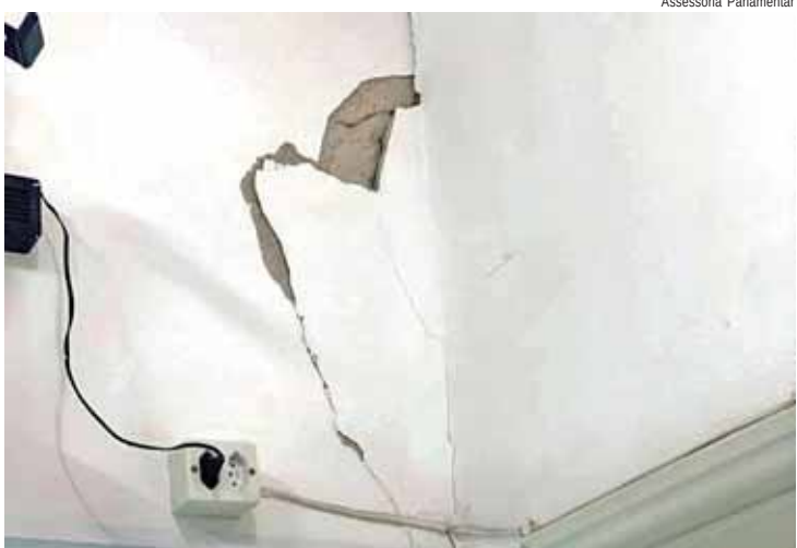
Vereador André Bandeira apresentou pedido à Prefeitura após denúncias sobre a estrutura e as condições insalubres da USF IAA 1, no bairro Santa Terezinha
