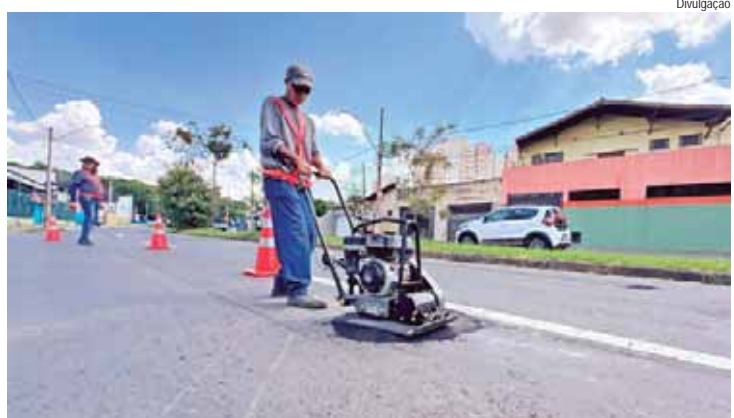
Para facilitar a cobertura de aberturas de pequeno diâmetro no asfalto, equipe utiliza placa vibratória e massa fria
