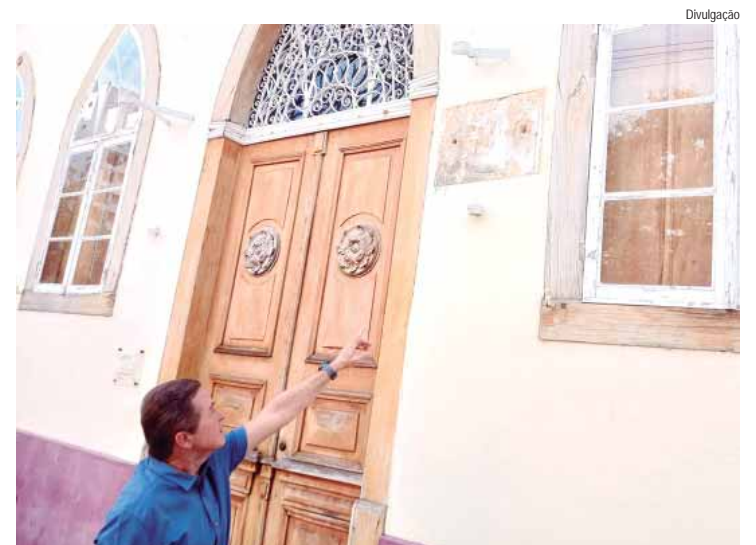
Documento enviado ao Executivo solicita reforma, pintura e substituição de lambrequins deteriorados
