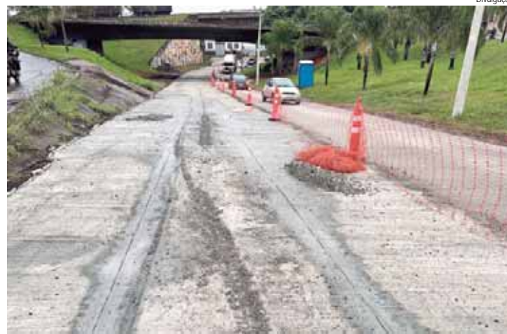
Quinze placas de concreto foram prejudicadas por pessoas de moto que retiraram a sinalização e entraram em área fechada para cura do material
