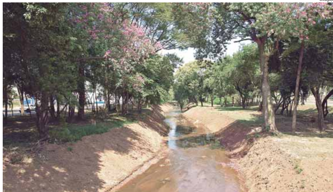
Serviços de desassoreamento e alargamento de canal no ribeirão do Enxofre foram concluídos
