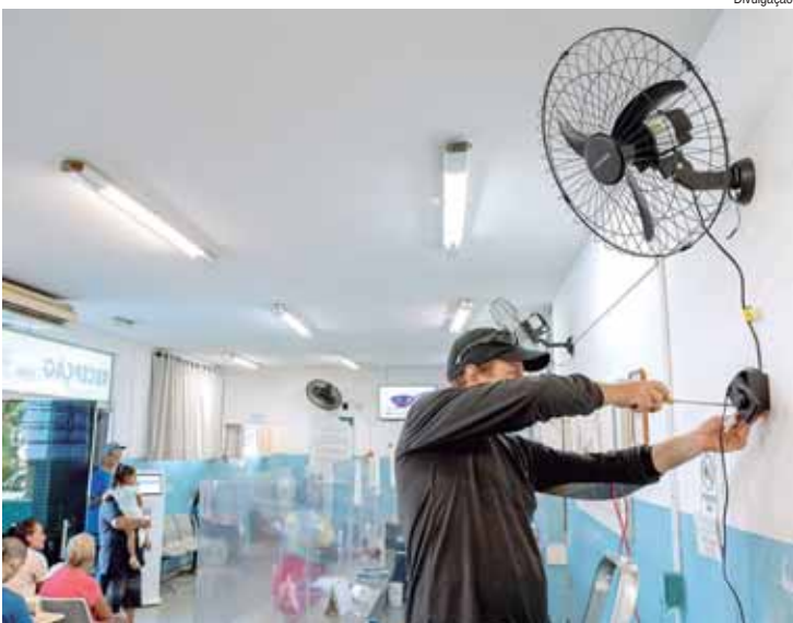
Novos ventiladores começaram a ser instalados hoje nas unidades de emergência, entre eles a COT
