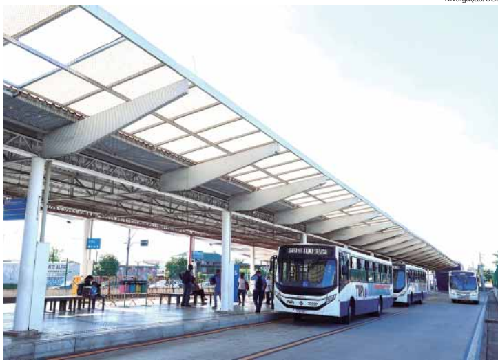
Estrutura foi danificada devido às chuvas na cidade em novembro
