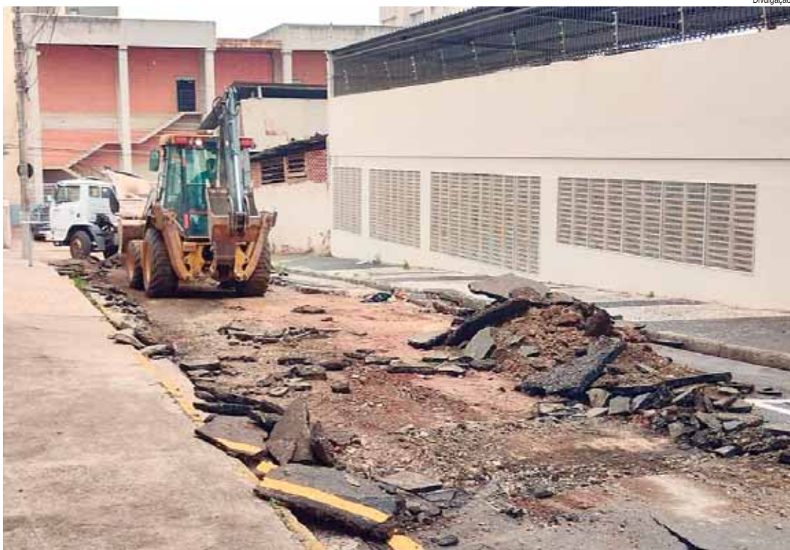
Semozel atua na limpeza da travessa Williards Guidotti, que teve asfalto prejudicado
