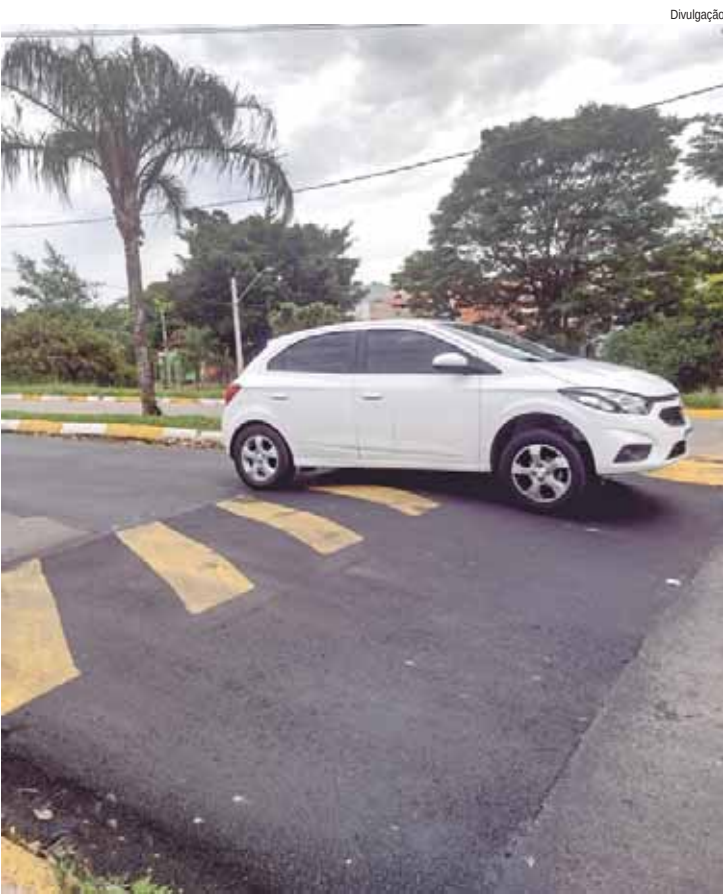
Lombada com aumento de volume de massa asfáltica
