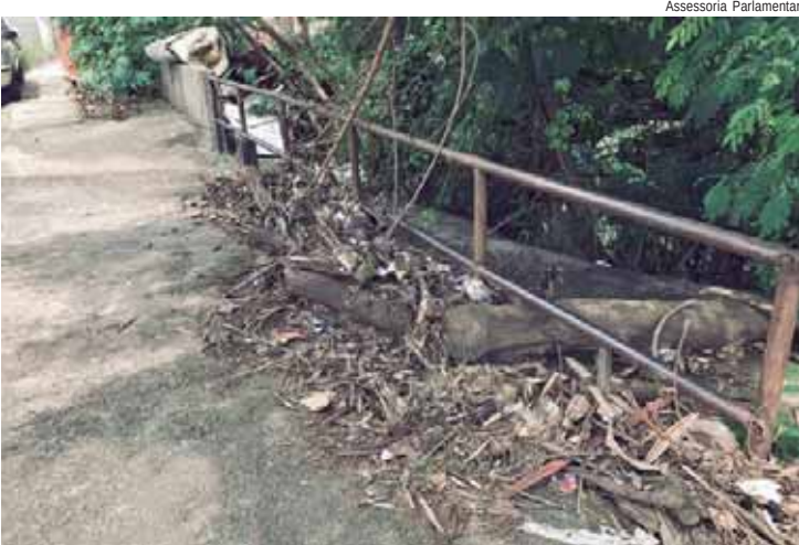
Margem do Córrego do Enxofre precisa de limpeza; cratera traz risco ao trânsito
