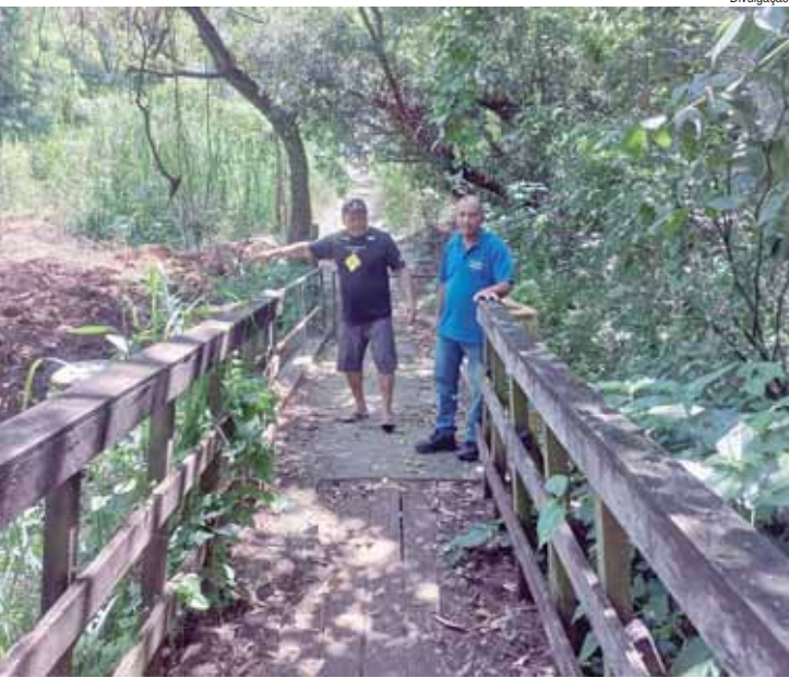
Paraná se comprometeu a encaminhar ao Executivo indicação solicitando, em caráter de urgência, a reforma da ponte
