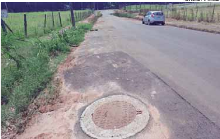
Sem escoamento, local acumulava esgoto, o que causava mau cheiro e incômodo aos moradores vizinhos
